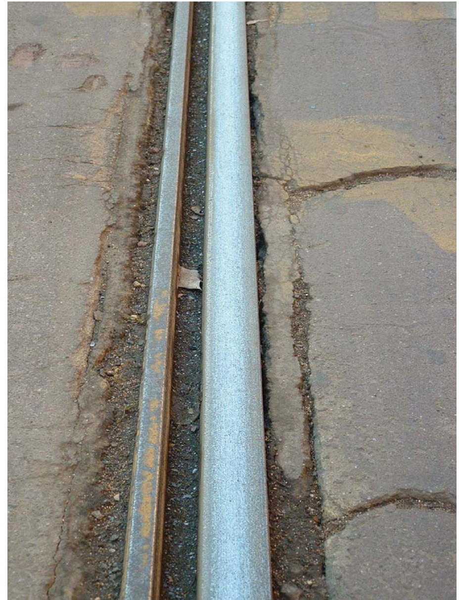
Fig. 7. Roma, particolare della sede tranviaria prima dei lavori di rifacimento della via di corsa in via Labicana: si noti l'assenza di materiale isolante, il distacco e le screpolature del manto stradale ad opera delle vibrazioni e degli agenti atmosferici.
