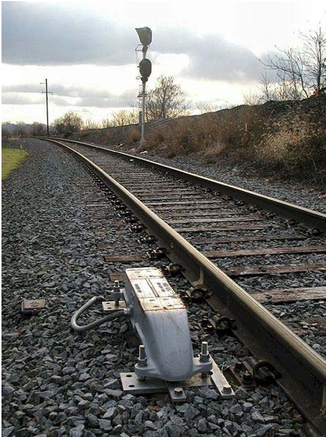
Fig. 14. Segnalamento di linea: particolare di un relé a induzione.
