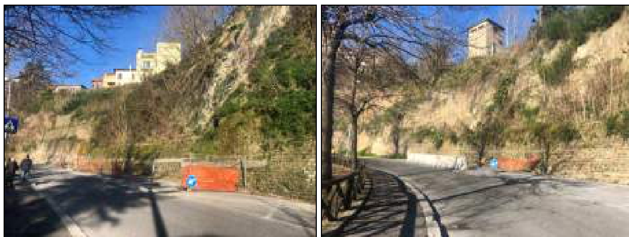
Foto 3 - 4: Visione delle opere soggette a rischio presenti a ridosso del versante instabile.
