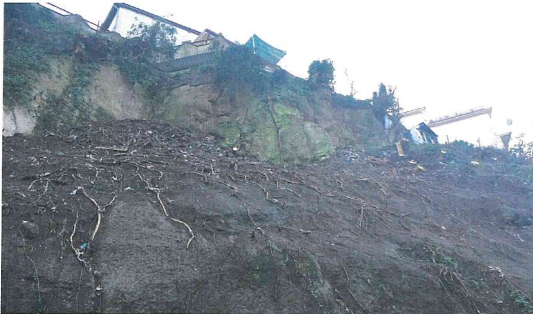
Figura 11. La porzione superiore della scarpata è interessata da un complesso sistema di fratturazione che conduce all'individuazione di blocchi isolati, da rimuovere mediante interventi di disaggi o da consolidare mediante chiodature e reti corticali
