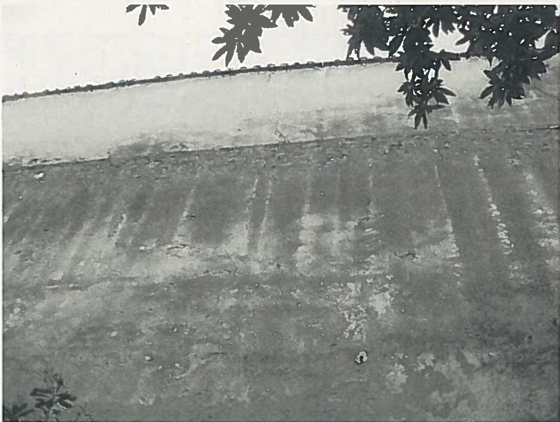
Foto 2 - Dettaglio lesioni lato interno scuola e sopraelevazione muro
