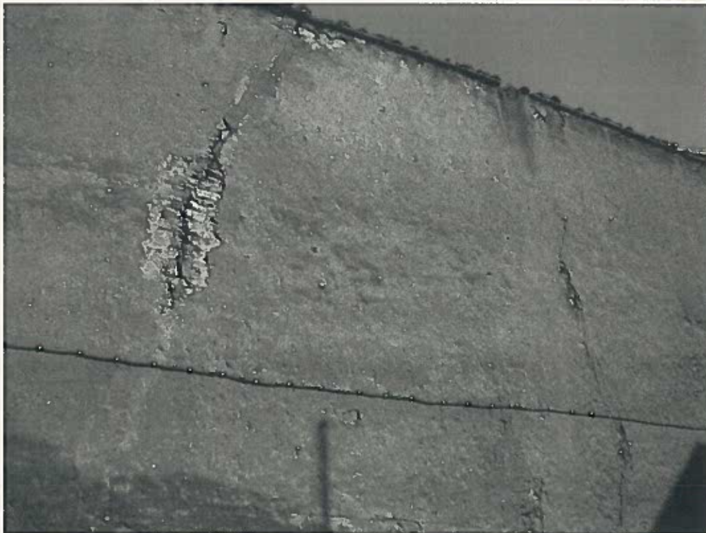
Foto 6 - Dettaglio lesioni su Vicolo della Frusta
