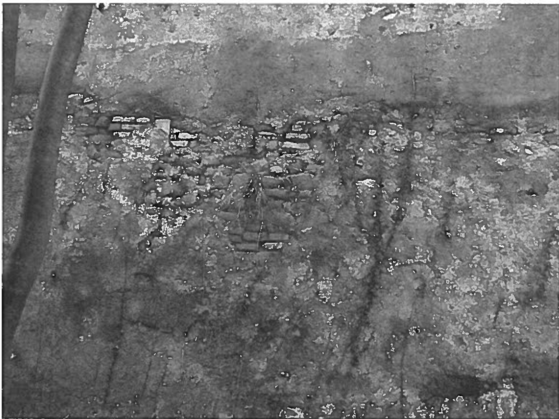
Foto 4 - Dettaglio muratura lato interno con distacco intonaco
