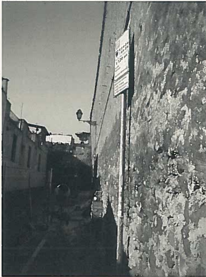
Foto 5 - Vista muro con dettaglio dello "spanciamiento" su Vicolo della Frusta
