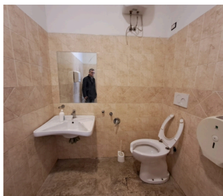
Servizio igienico persone con disabilità
