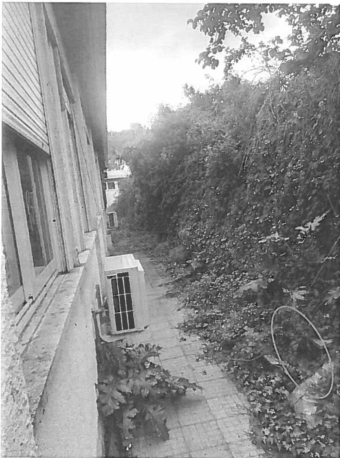
Foto 19 – padiglione “I” – lato del fabbricato parallelo a via Barellai al confine con l’alloggio del custode – vista della vegetazione da sfoltire e dei muretti bassi da demolire e ricostruire evidenziati con l’ovale e che si sviluppano per tutta la lunghezza del blocco.
