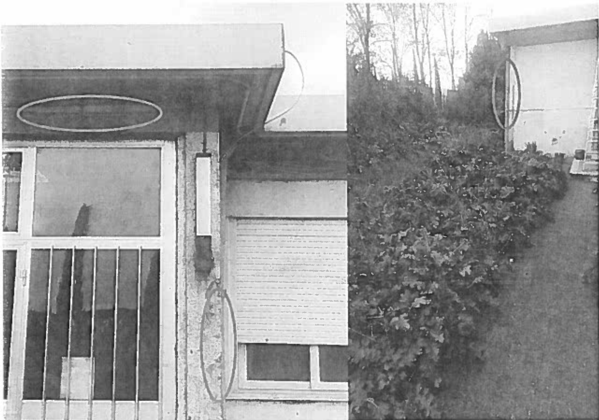
Foto 9 e 10 - padiglione "I" - deterioramento dei pilastri e della trave di coronamento e trattamento dei ferri.
