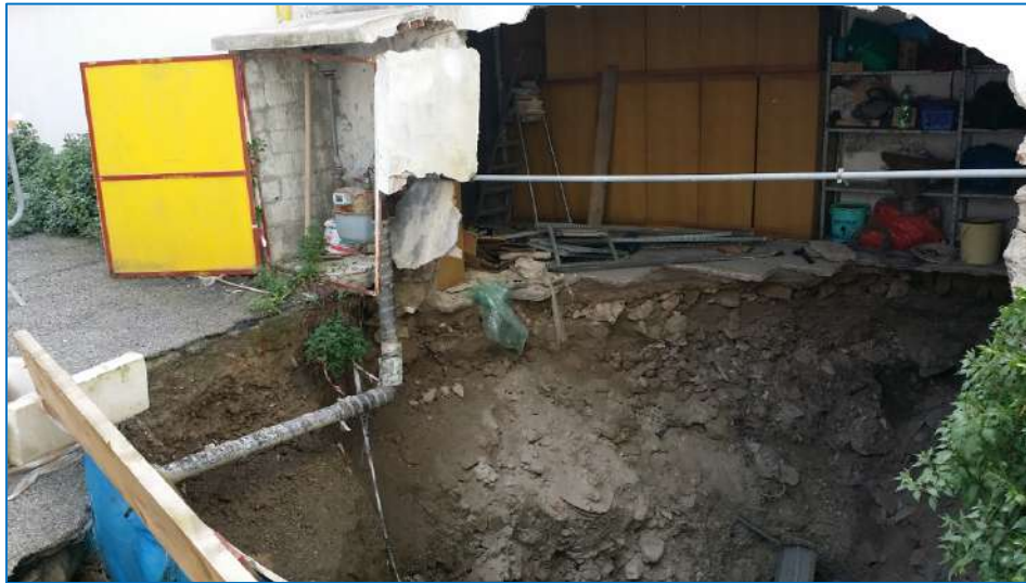
Figura 3: Cavo da mettere in sicurezza
