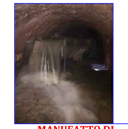
MANUFATTO DI SCARICO Manuf. in Cemento con Sez. 1.00x1.00 m poggiato su basamento di c/c di 50 cm
