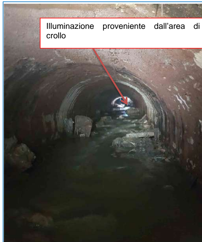
Figura 5: Detriti massivi tra il CS12 ed il CS13
