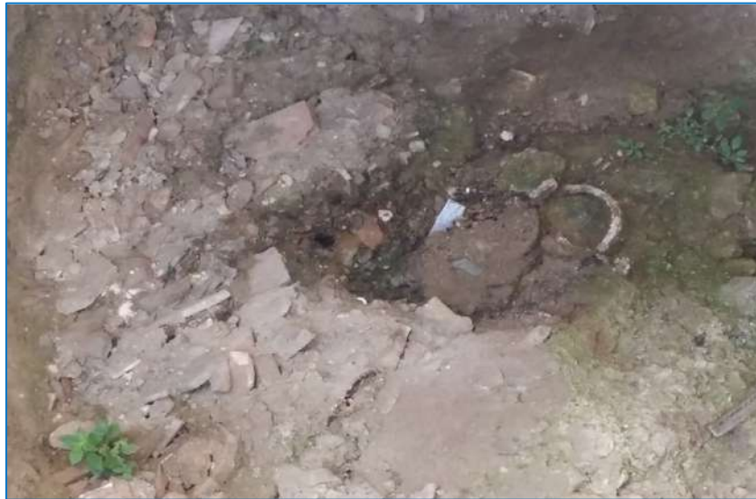
Figura 6: Anomala macchia di umidità sul cono detritico
