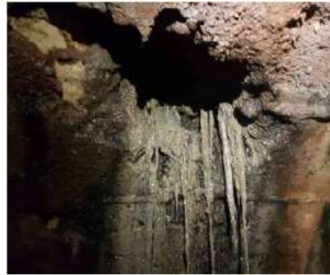
Fig. 43: Scarichi SC04 – SC05
